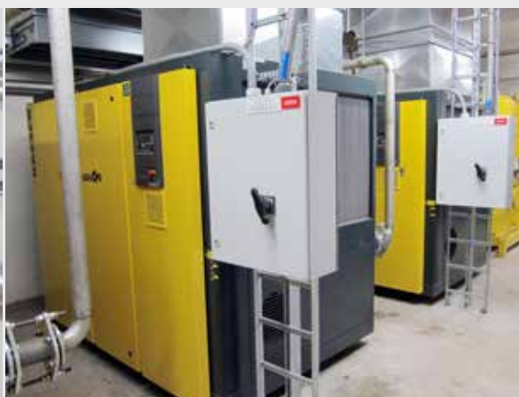
Den nye «varmesentralen» som mottar og varmeveksler det oppvarmede kjølevannet til både varmtvannstanker og mot ventilasjonsaggregat i garderobebygget vårt.
